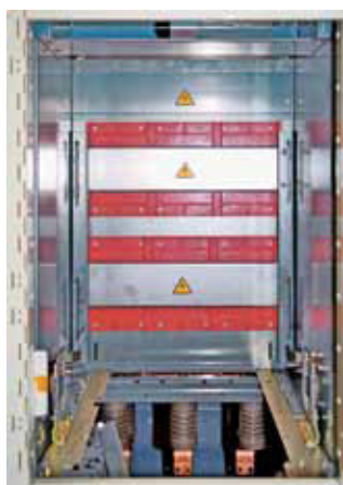
Compartimento HVX com acesso ao compartimento
