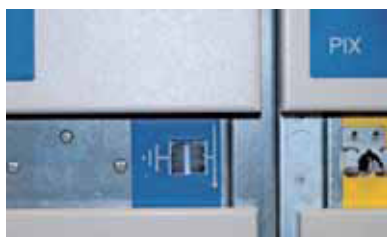
Indicador de posição da chave de aterramento
