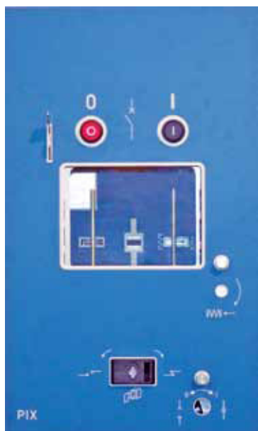
Painel de operação
