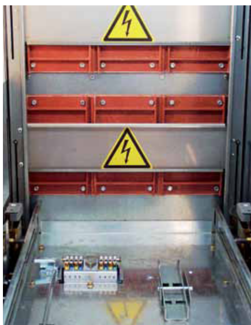
Compartimento do circuito principal.
