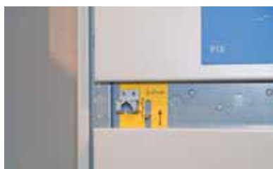
Bloco de comando da chave de aterramento
