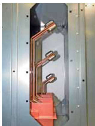
Compartimento do barramento
