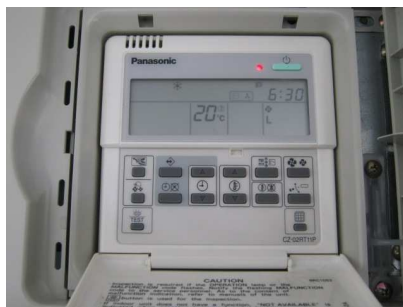
Figura 10- Setpoint definido numa das unidades interiores de climatização.
