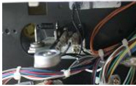
10 Front door switch
