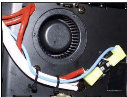
Fig. 52. Cable ties at left fan
