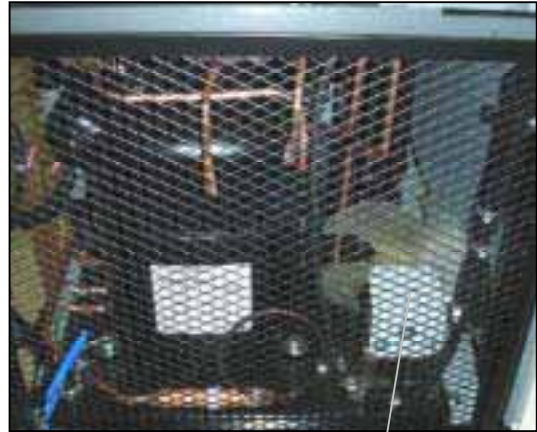
Condensing fan motor R
