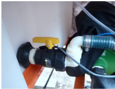
Fill valve in fill position
