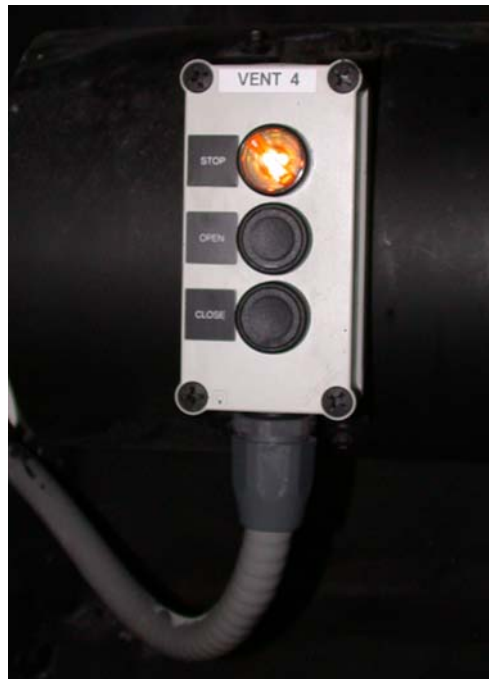
Manual Vent Door Controls
