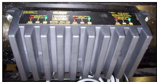
230 volt battery charger
