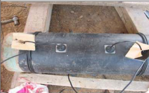
Foto 9: Vista superior de soldadura en frío Protabond. Resistencia entre extremos de cable 0.2 Ohm.
