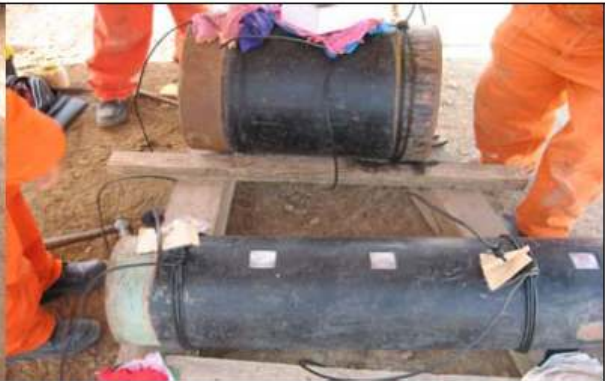
Foto 2: Enrollamiento - aseguramiento del cable en el caño. El Handy cap y la sopapa son insertados en el cable.
