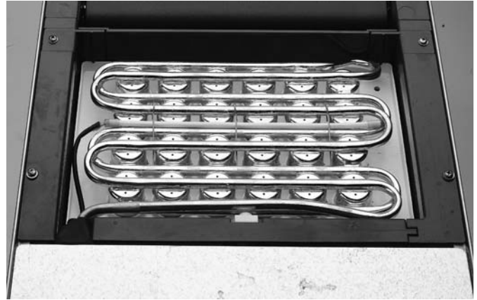
Pour Scale Remover Over The Evaporator Section
