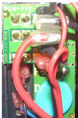
LOAD DUMP Module
